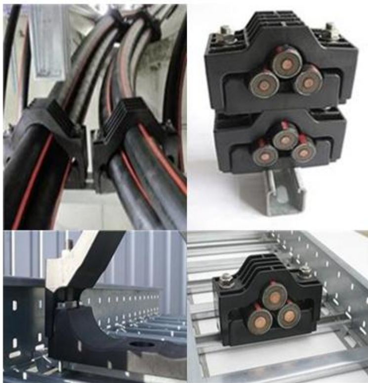
Figura 3 – Suporte para fixação de cabos.
