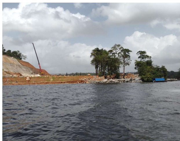
Amostragem trimestral em fevereiro/2024 no ponto a jusante (JUS 01) do local onde está sendo construída a PCH Salto Cafesoca. Crédito: Diego Rangel
