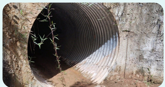
Passagem de fauna com armadilha de pegada instalada.
